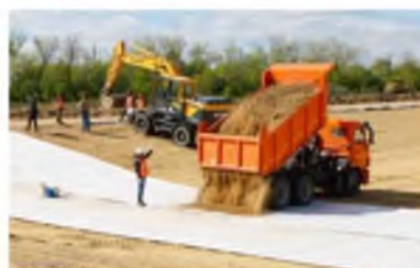
Бентонитовый мат допускает передвижение колесной спецтехники при укладке (без резких поворотов, по не гидратированному мату)
